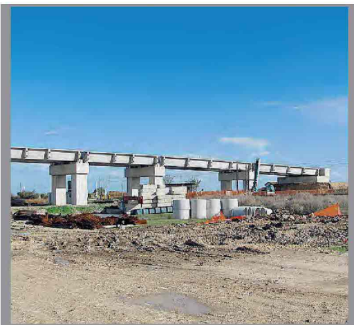
■ In alto un tratto della Linea Termoli-Lesina; qui sopra lavori per l'alta capacità; in basso la stazione di Foggia
